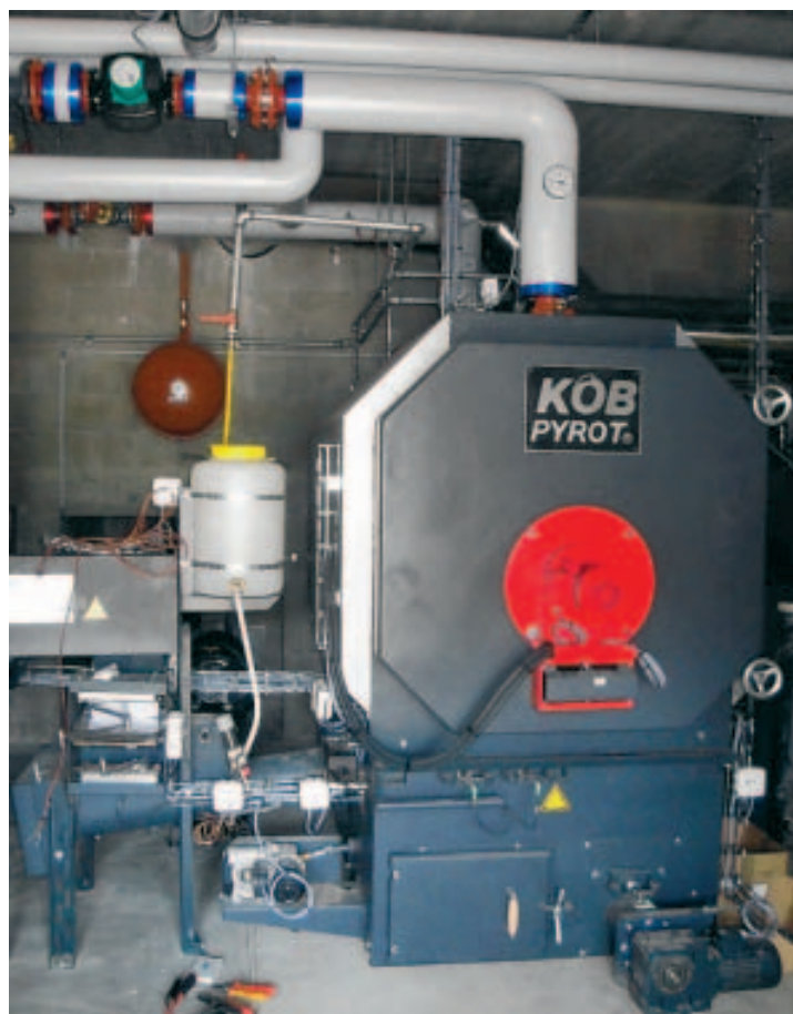
La chaudière sera alimentée avec des plaquettes de bois. ■ N.L.
